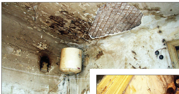
Рушится потолок на кухне.
